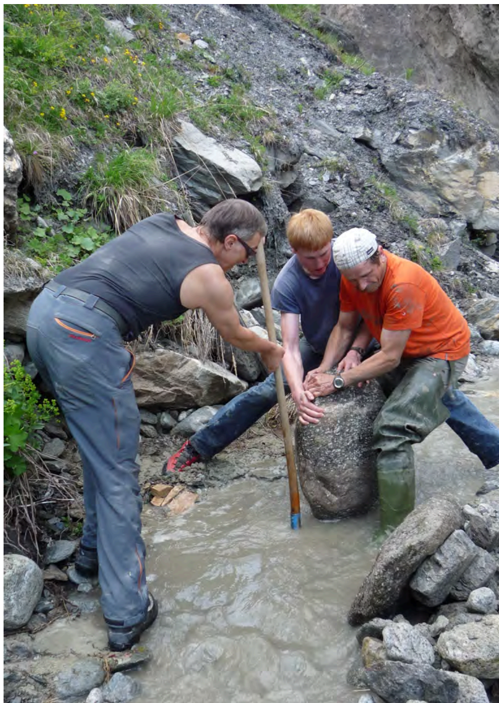
Collectif au travail dans le bisse de Niwärch VS : déblaiement de la prise d'eau. Droits d'auteur : SL-FP
